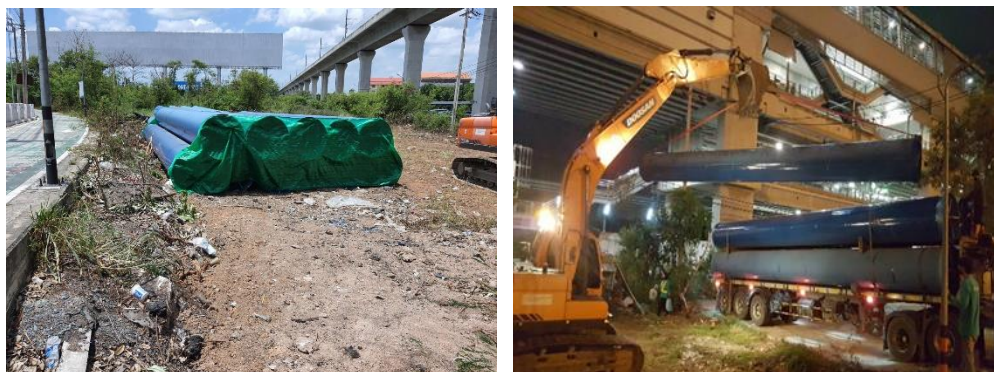
ภาพที่ 1.3 ภาพการรื้อย้ายท่อน้ำประปาใต้ดิน บริเวณสถานีรถไฟฟ้าวอเตอร์เรลลิงก์
