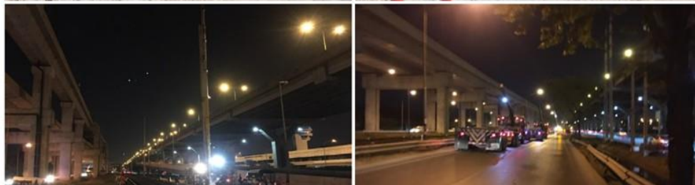
ภาพที่ 1.5 การรื้อย้ายสาธารณูปโภคเพื่อก่อสร้างรถไฟความเร็วสูงเชื่อม 3 สนามบิน
